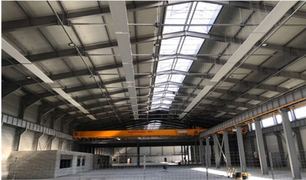
Juli 2018: > 1 km Sabiana Radiant Panel
